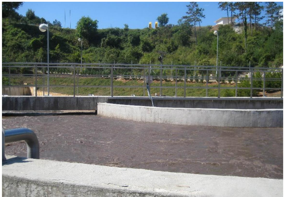
Slika 9 – Unutarnji bazen za denitrifikaciju
