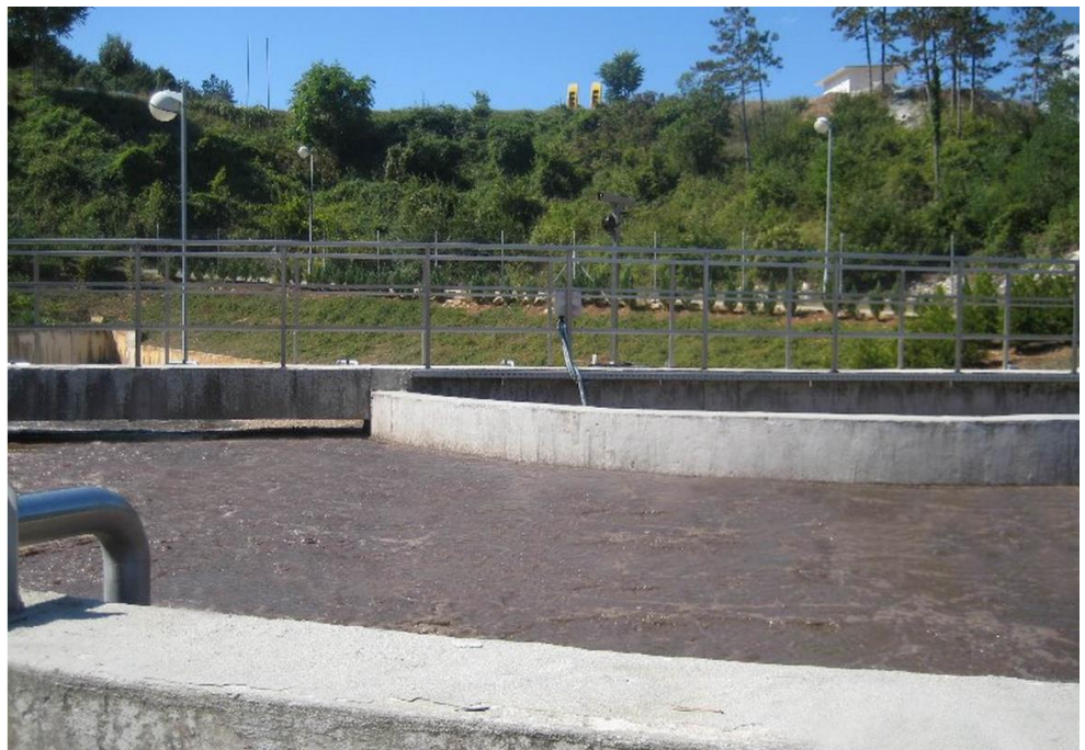
Slika 9 – Unutarnji bazen za denitrifikaciju
