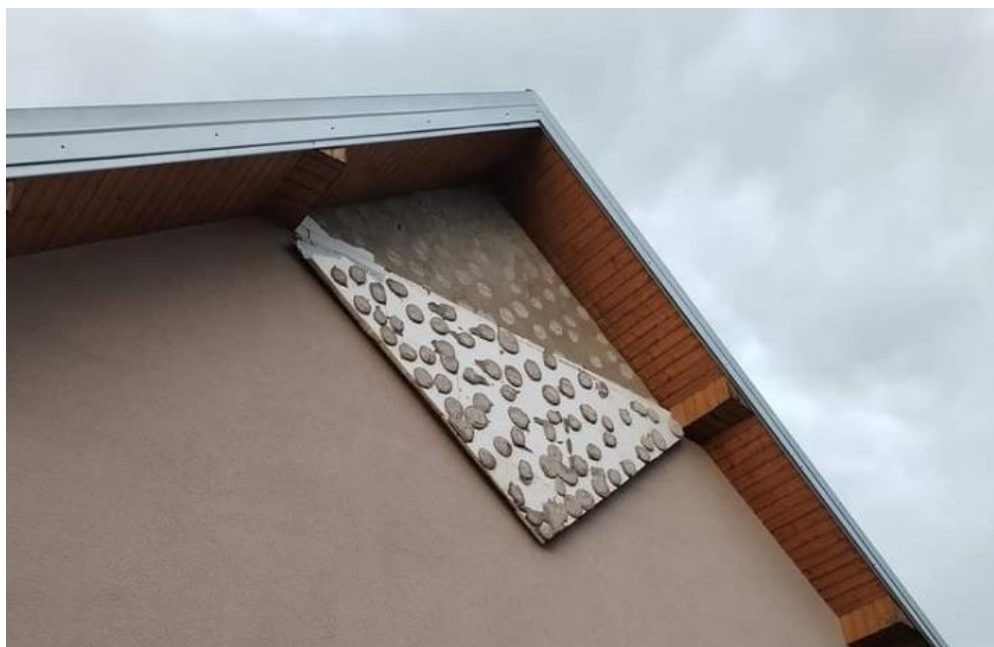
Slika 28. Nepravilno izvedena izolacija stiroporom
