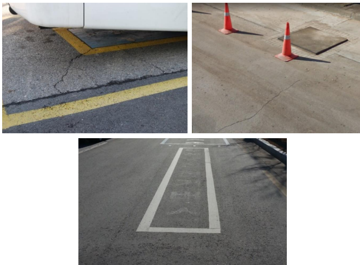
Slika 4.2: Oštećenja asfalta na kritičnim točkama kod induktivnih ECS-a. Gore su prikazana dva primjera longitudinalnih reflektirajućih pukotina koje su prodrle na površinu asfalta. Dolje je prikazano propadanje asfalta. [6]
