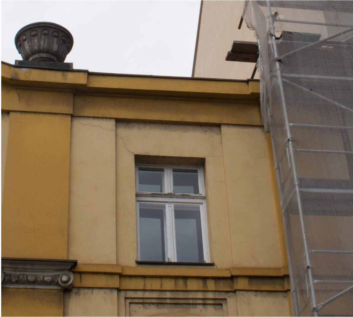
Slika 30 Dijagonalna pukotina na uglu otvora
