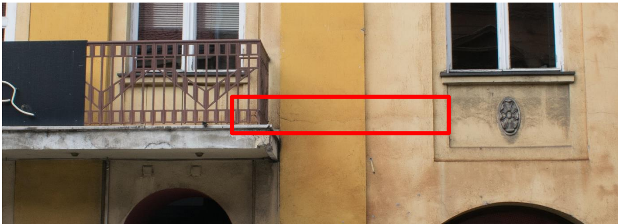
Slika 28 Horizontalna pukotina s druge strane balkona
