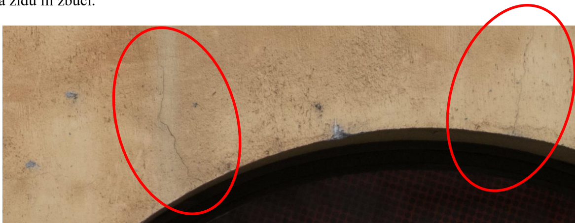
Slika 31 Pukotine na luku
