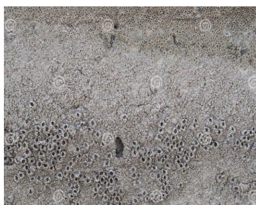
Slika 18 Školjke na betonu
