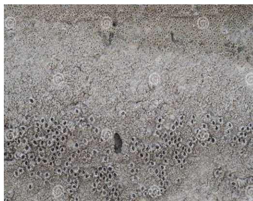
Slika 18 Školjke na betonu
