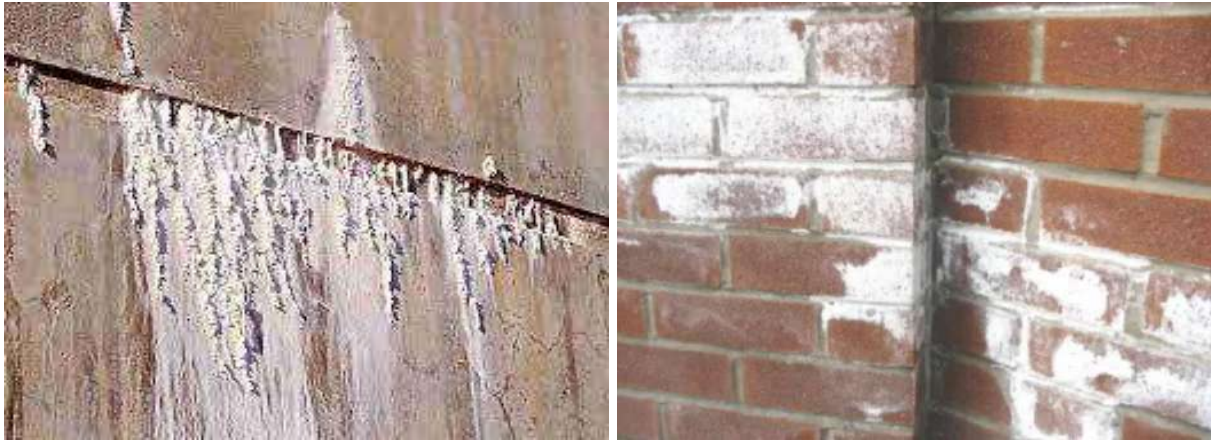
Slika 4.13. Iscvjetavanje na površini elementa
