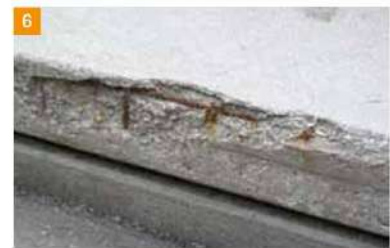
Konačna faza oštećenja korozijom
