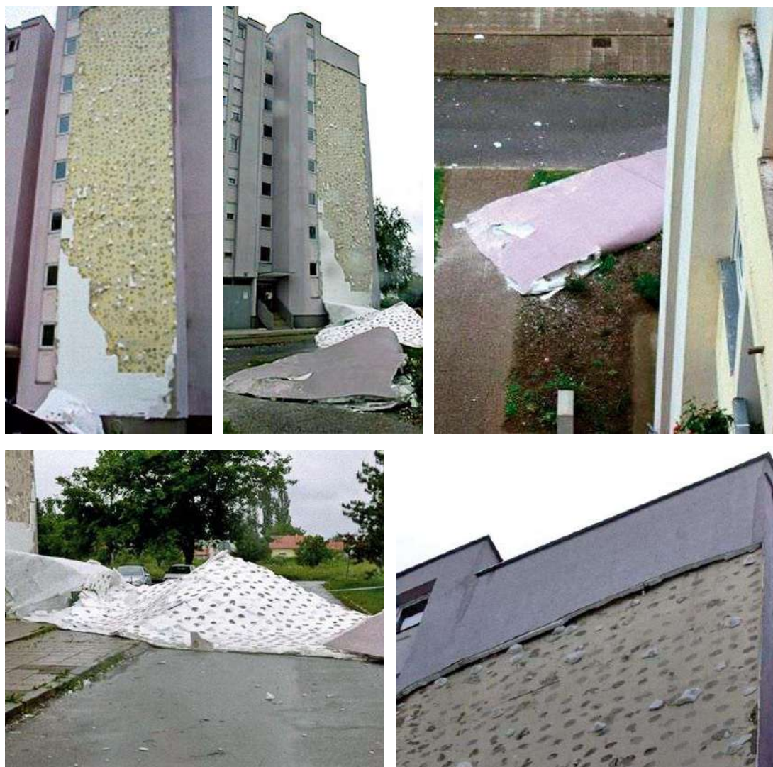
Slika 11. Neodgovarajuće ugrađen ETICS sustav, Vukovar, svibanj 2010
