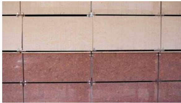
Slika 23. Loša montaža podkonstrukcije
