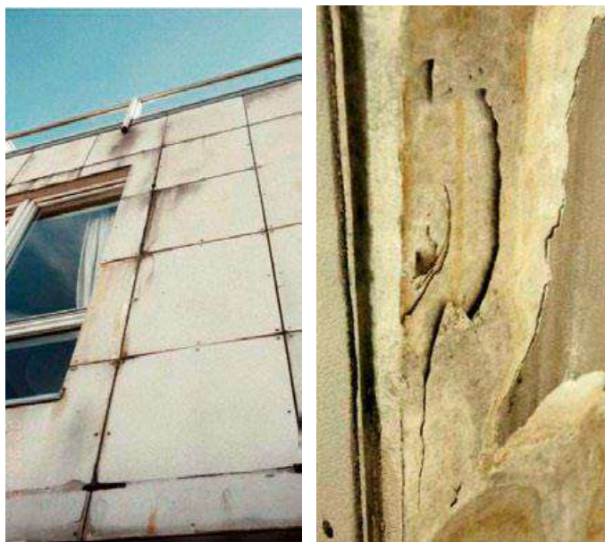
Slika 25. Primjer oštećenja završne obloge uslijed nedovoljne ventilacije prostora iza obloge što je dovelo do smrzavanja vlage i oštećenja ploča
