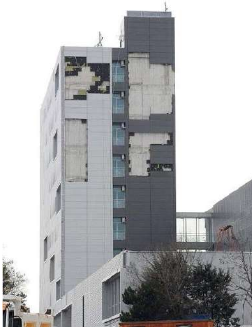
Slika 24. Oštećenja uslijed jake bure, Trsat, Rijeka
