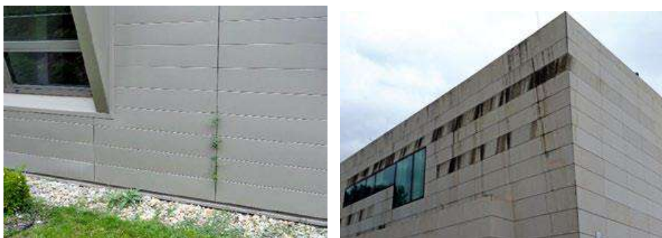
Slika 26. Primjer oštećenja ventilirane fasade: rastom vegetacije iz fuga između panela (lijevo) i primjer rasta gljivica (desno)
