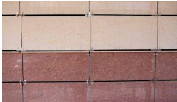
Slika 23. Loša montaža podkonstrukcije
