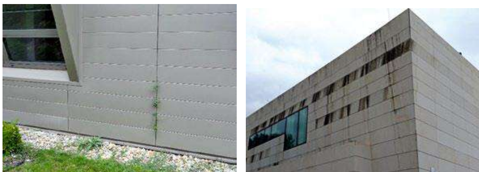
Slika 26. Primjer oštećenja ventilirane fasade: rastom vegetacije iz fuga između panela (lijevo) i primjer rasta gljivica (desno)
