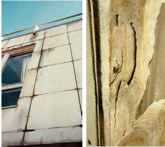
Slika 25. Primjer oštećenja završne obloge uslijed nedovoljne ventilacije prostora iza obloge što je dovelo do smrzavanja vlage i oštećenja ploča
