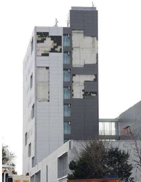
Slika 24. Oštećenja uslijed jake bure, Trsat, Rijeka
