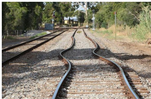
Slika 7: Deformacije tračnica željezničkih pruga uzrokovane visokim temperaturama [14]
