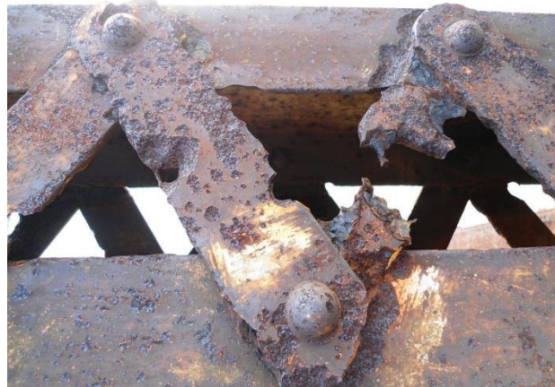
Slika 9: Prikaz izražene korozije i raspadanja metalnih dijelova konstrukcija [16]
