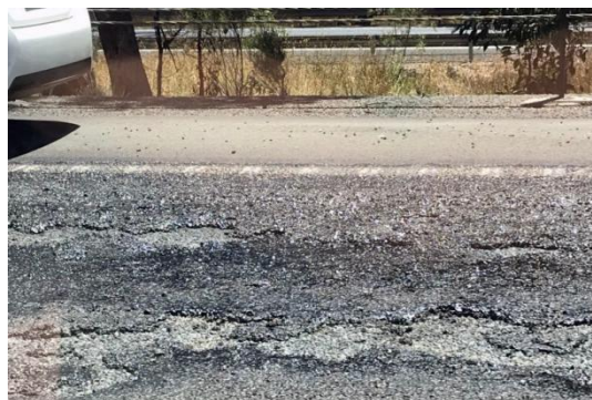
Slika 8: Pojačano habanje asfaltnog sloja ceste kao posljedica utjecaja visokih temperatura [15]
