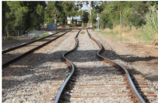
Slika 7: Deformacije tračnica željezničkih pruga uzrokovane visokim temperaturama [14]
