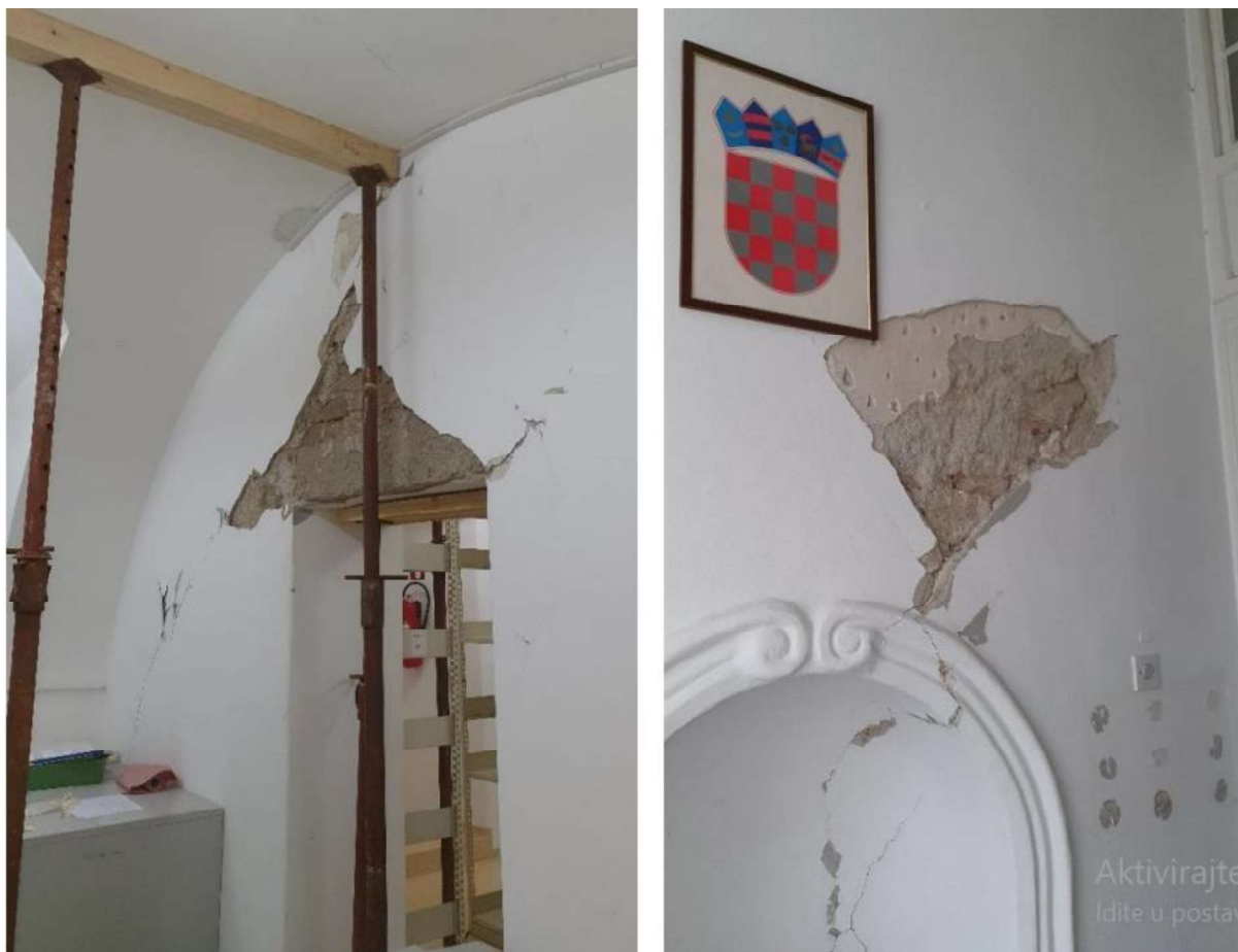
Slika 1 Pukotine, oštećenja i opadanje žbuke u prizemlju(Duvnjak,2021)
