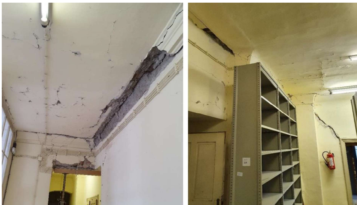
Slika 3 Pukotine, oštećenja i opadanje žbuke na 2. katu zgrade (Duvnjak, 2021)
