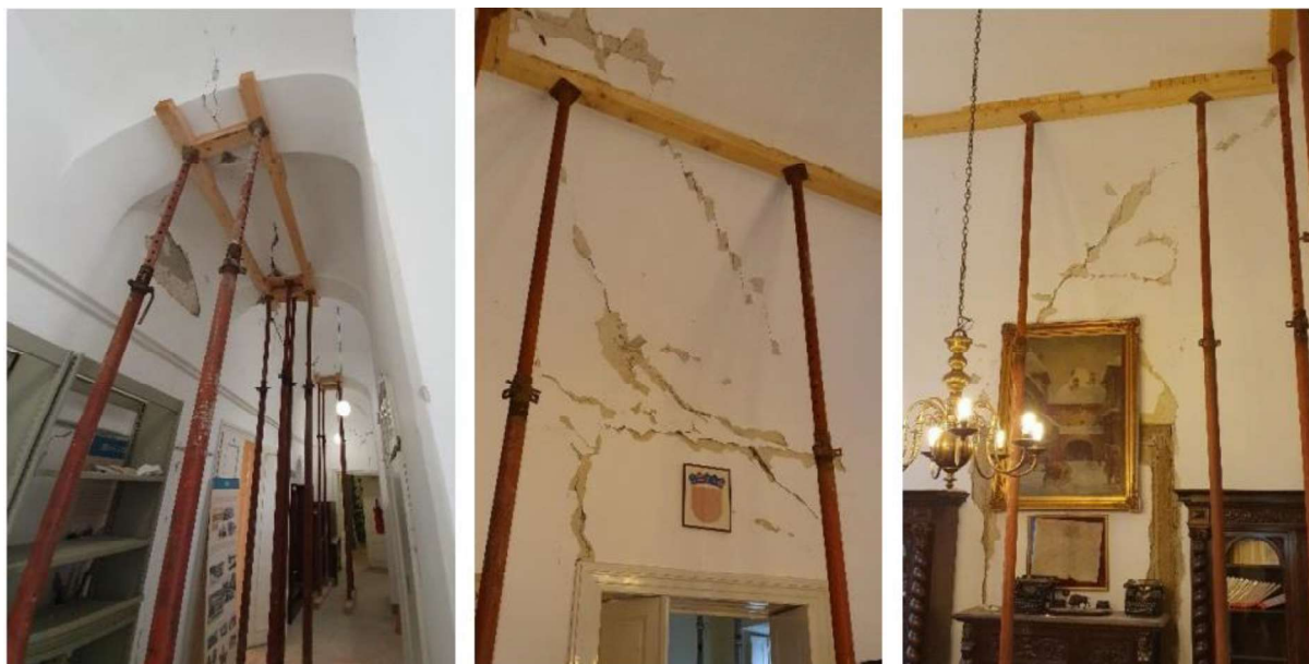
Slika 2 Pukotine i oštećenja na svodovima 1. kata zgrade (Duvnjak, 2021)
