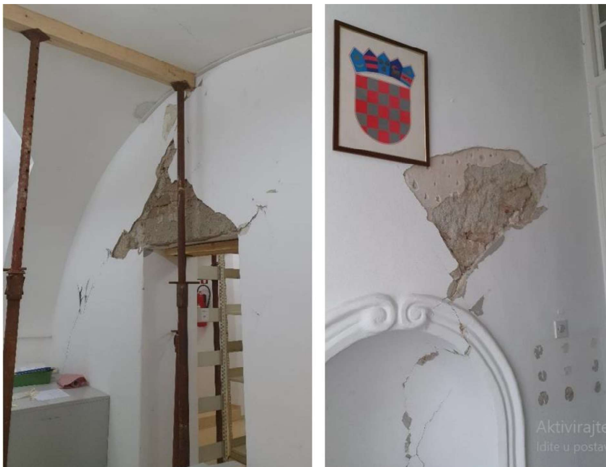
Slika 1 Pukotine, oštećenja i opadanje žbuke u prizemlju(Duvnjak,2021)
