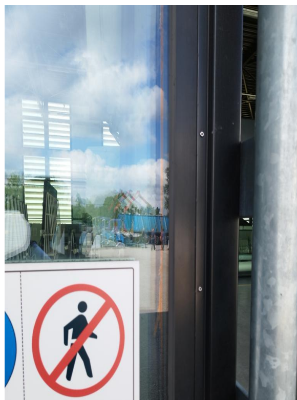
Slika 26 Primjer korodiranog low-E premaza
