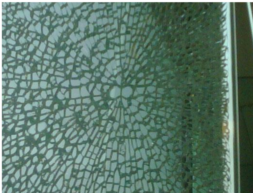
Slika 40 Primjer puknuća stakla nastalog ekspanzijom NiS [41]
