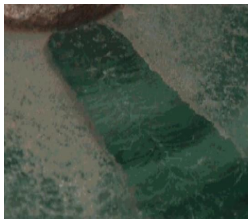
Slika 21 Prikaz korodiranog stakla [30]
