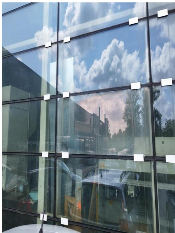
Slika 27 Primjer korodiranog low-E premaza
