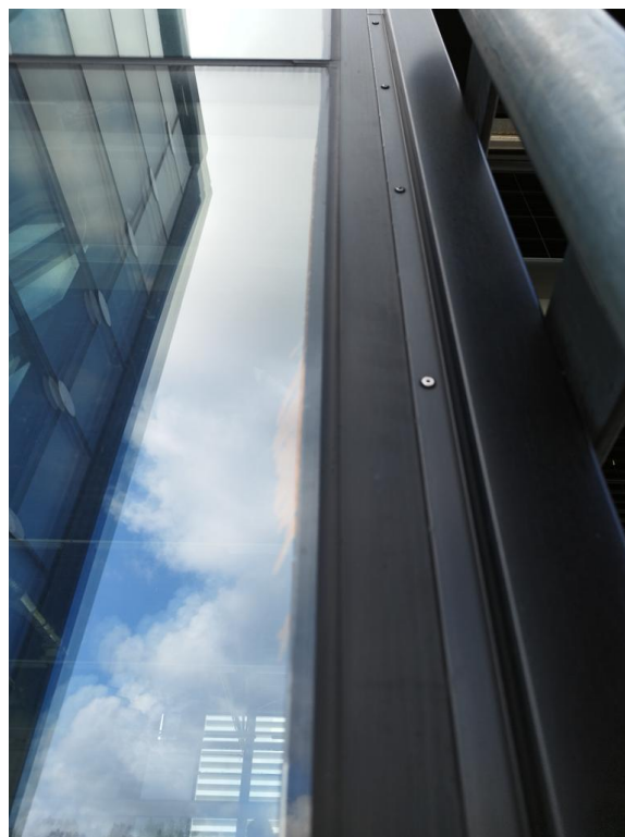
Slika 28 Primjer korodiranog low-E premaza
