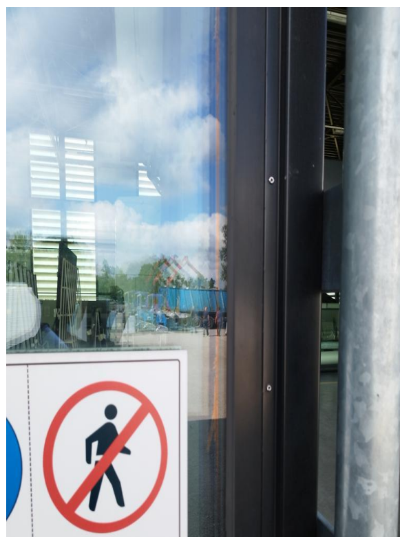
Slika 26 Primjer korodiranog low-E premaza
