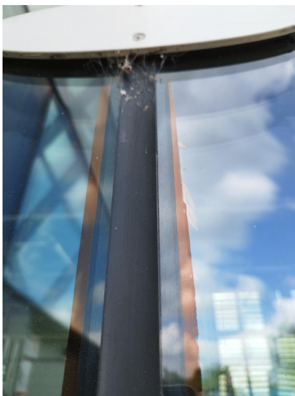
Slika 25 Primjer korodiranog low-E premaza
