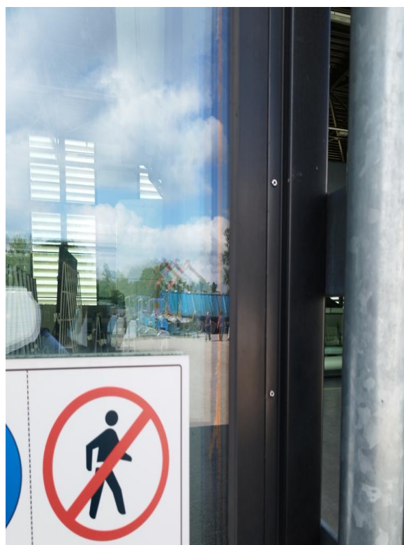
Slika 26 Primjer korodiranog low-E premaza
