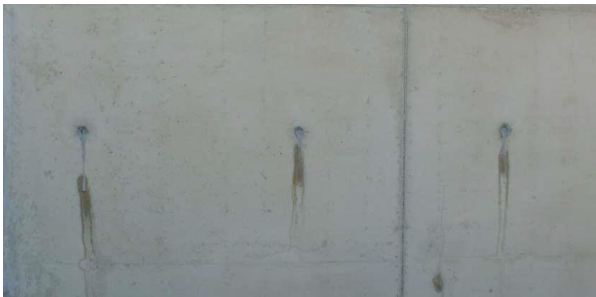
Slika 6. Pukotine prilikom skupljanja u vrijeme očvršćivanja betona
