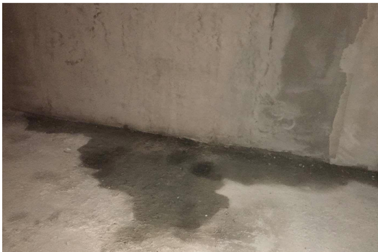
Slika 7. Radni takt loše izveden - spoj temeljna ploča i podrumski zid
