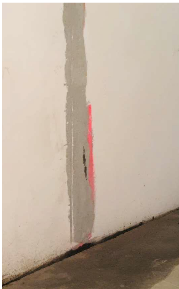
Slika 5. Prekid betoniranja - radni taktovi loše izvedeni
