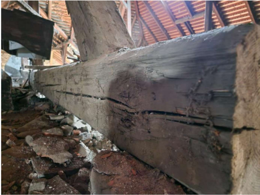
Slika 26. Uzdužno oštećenje na jednoj veznoj gredi
