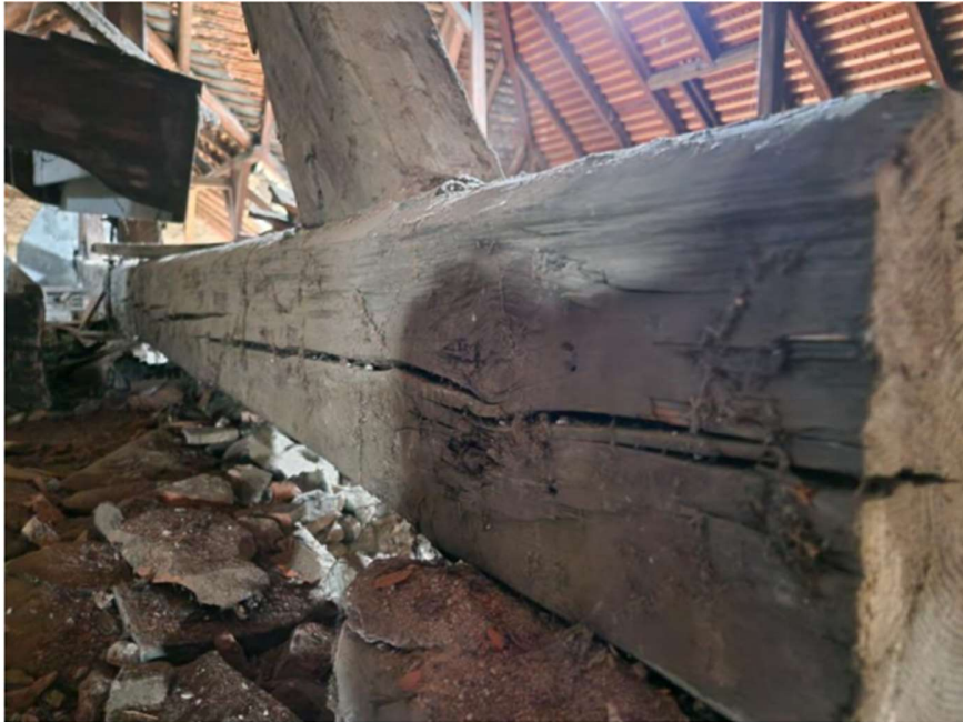
Slika 26. Uzdužno oštećenje na jednoj veznoj gredi
