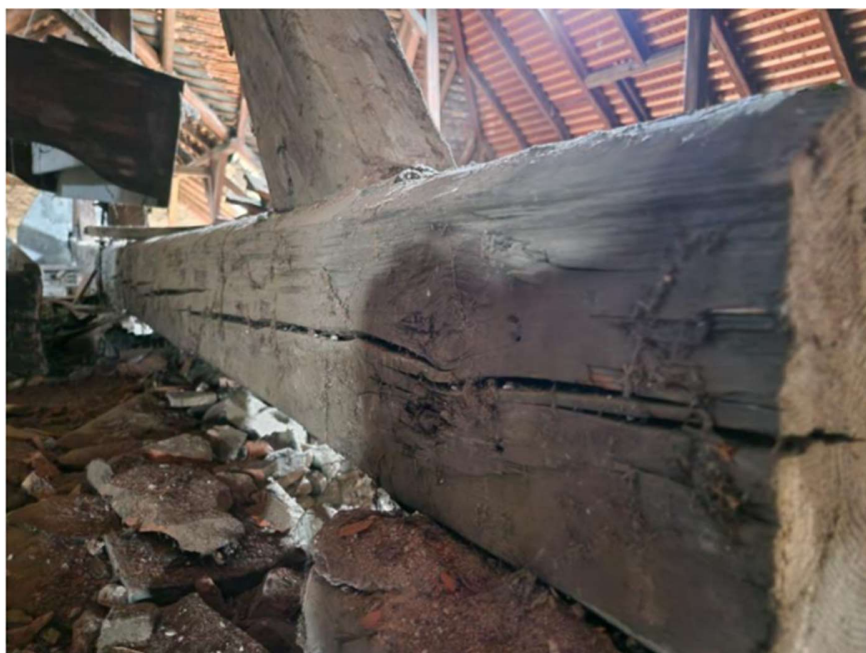
Slika 26. Uzdužno oštećenje na jednoj veznoj gredi
