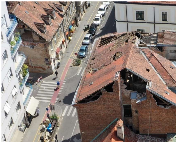
Slika 1. Prikaz oštećenja tipične donjogradske zgrade u Zagrebu
