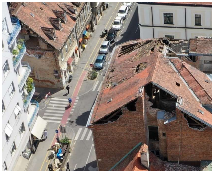
Slika 1. Prikaz oštećenja tipične donjogradske zgrade u Zagrebu
