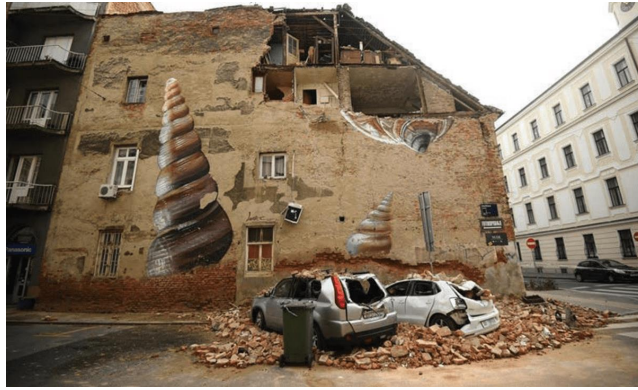
Slika 13 Primjer prevrtanja zida van ravnine uzrokovan neispravnom povezanosti elemenata konstrukcije [6]
