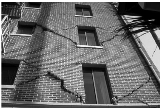
Slika 16 Dijagonalne pukotine kao posljedica slabih točaka na mjestima otvora [14]
