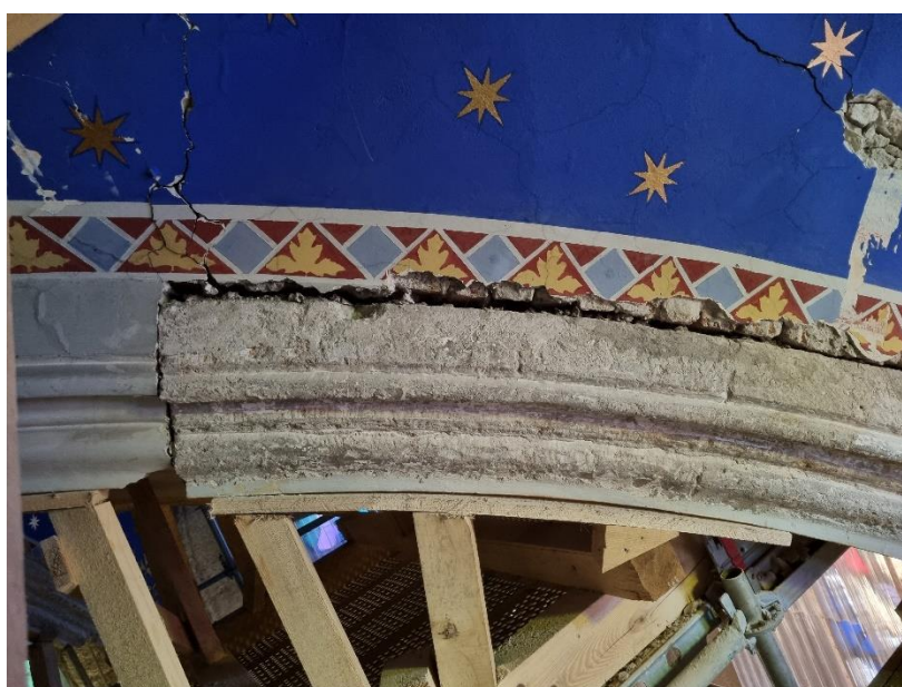
Slika 21. Detalj sloma rebara na svodu crkve (Foretić, 2021)
