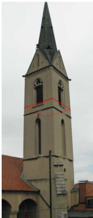
Slika 30. Pogled na zvonik s jugo-zapada, označena ravnina u kojoj je došlo do uvrtnja zvonika (Foretić i Trogrlić, 2021)
