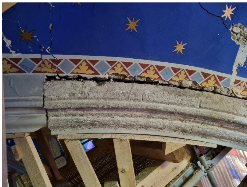
Slika 21. Detalj sloma rebara na svodu crkve (Foretić, 2021)
