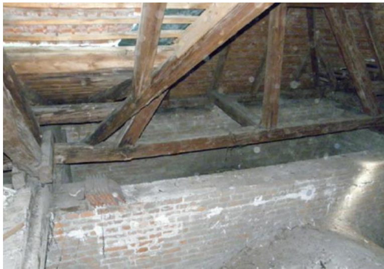
Slika 27. Oštećenje greda drvenog krovništva (Foretić i Trogrlić, 2021)
