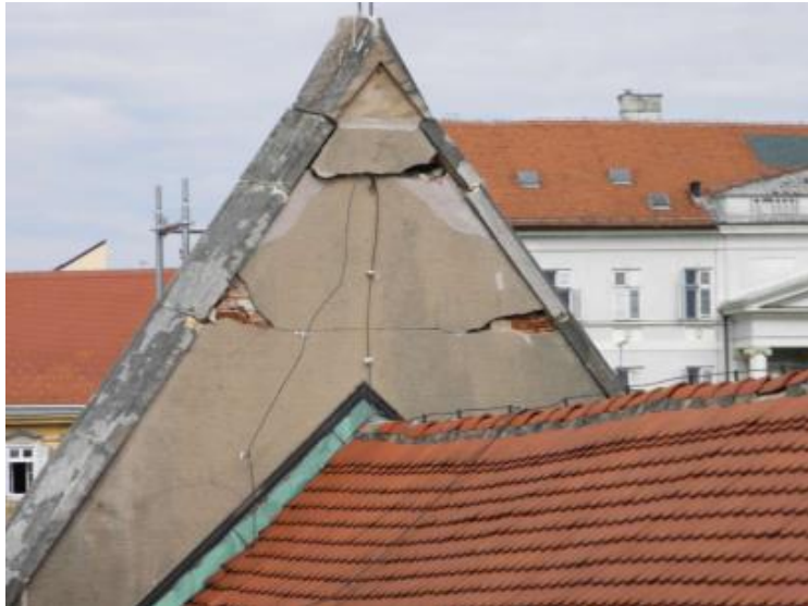
Slika 26. Veliko oštećenje na vrhu zabatnog zida (Foretić i Trogrlić, 2021)
