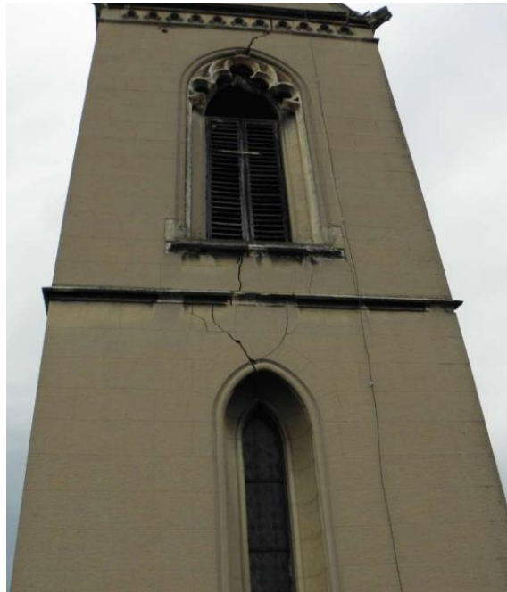
Slika 28. Karakteristične pukotine nadvoja na istočnom zidu zvonika (Foretić i Trogrlić, 2021)
