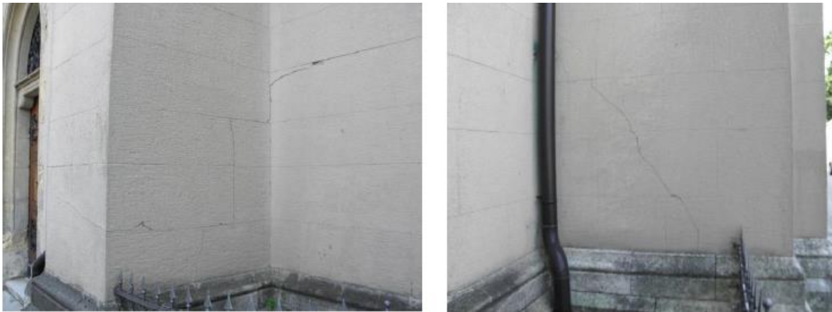
Slika 24. Pukotine u kontraforima na vanjskom sjevernom zidu (Foretić i Trogrlić, 2021)
