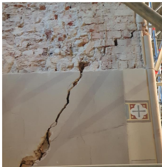
Slika 23. Slom kontrafora na unutarnjem sjevernom zidu (Foretić i Trogrlić, 2021)
