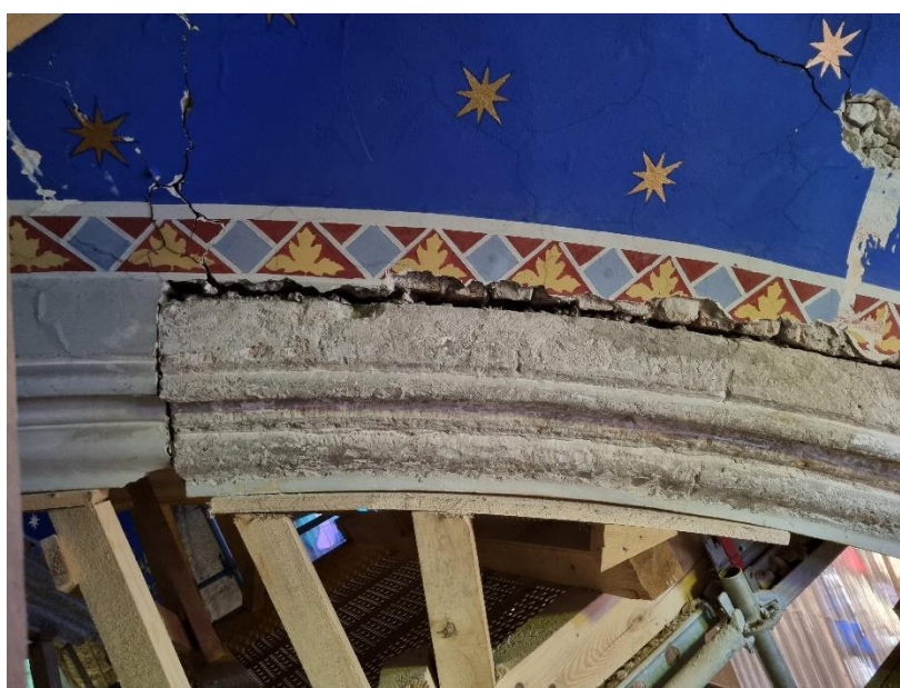
Slika 21. Detalj sloma rebara na svodu crkve (Foretić, 2021)
