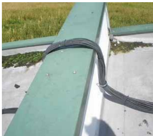
Slika 14 Nedozvoljeno postavljanje kablova preko požarnog zida (31)
