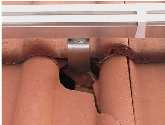
Slika 22 Uništen krovni pokrov kukom koja drži FN module (11)
