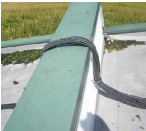
Slika 14 Nedozvoljeno postavljanje kablova preko požarnog zida (31)
