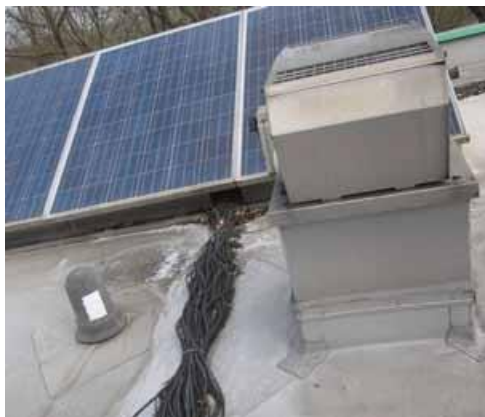
Slika 18 Nestručno postavljanje vodova (31)
