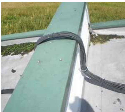
Slika 14 Nedozvoljeno postavljanje kablova preko požarnog zida (31)
