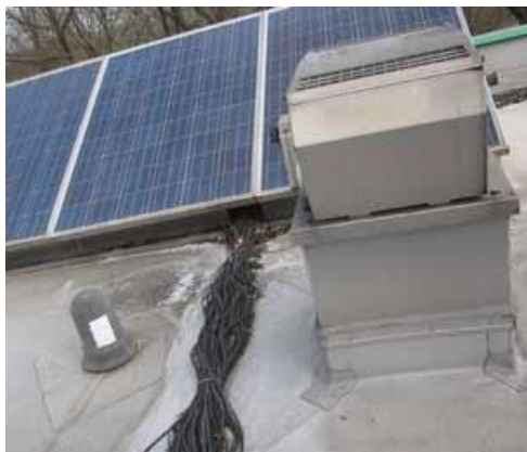
Slika 18 Nestručno postavljanje vodova (31)
