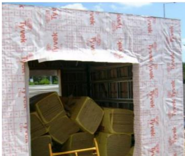
Slika 16: Vanjski sloj vjetrootpornih membrana oko otvora na vanjskoj fasadi LSF-a prije izvođenja ETICS-a [19]
