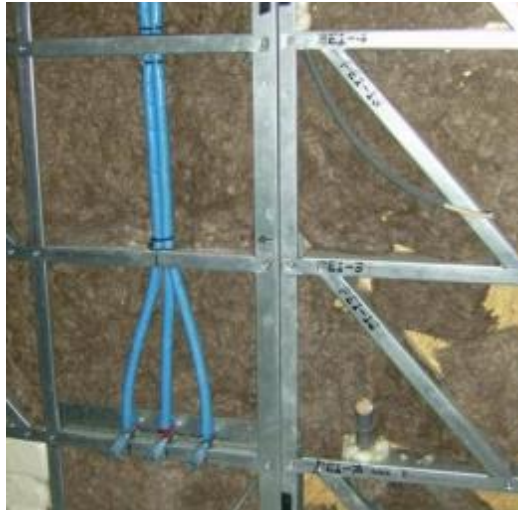
Slika 10: Tehnički uređaji između čeličnih okvira [19]
