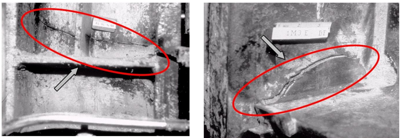
Slika 4 Krta lom donjih pojasnica grede u zavarenoj MRF vezi tijekom potresa Northridge, California, 1994 : lom koji se širi kroz spoj stupa i pojasnicu (lijevo) i lom koji uzrokuje otkazivanje stupa [5]
