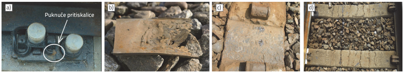
Slika 3. a) Primjer puknuća pritiskalice [10]; b) istrošenje podtračničkog podloška [20]; c) ležajnog mjesta na pragu [24]; d) puknuće betonskih pragova [23]
