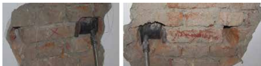
Slika 6. Stambena građevina, Palmotićeva ulica 64a u Zagrebu, ispitivanje posmične čvrstoće ziđa na mjestima PS-1-1 i PS-2-1
