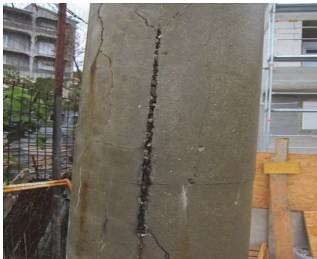
Slika 4. Oštećenja armiranobetonskog stupa u elektroprijenosnoj mreži – karakteristične pukotine u agresivnoj sredini
