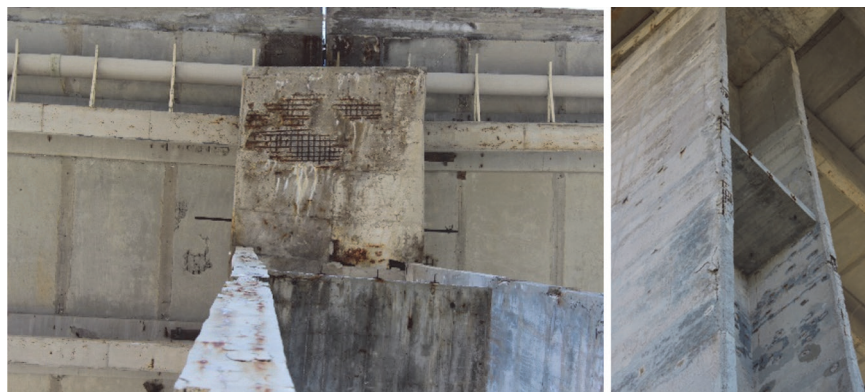
Slika 2. Oštećenja nadvožnjaka Bukovo na autocesti Zagreb – Rijeka
