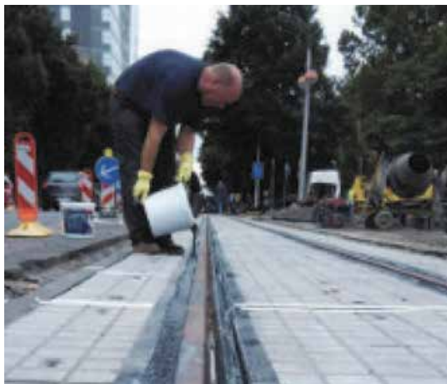
Slika 28. Ugradnja materijala za zapunjavanje umjesto traka za brtvljenje na dionici tramvajskog kolosijeka u Savskoj cesti, Zagreb [9]
