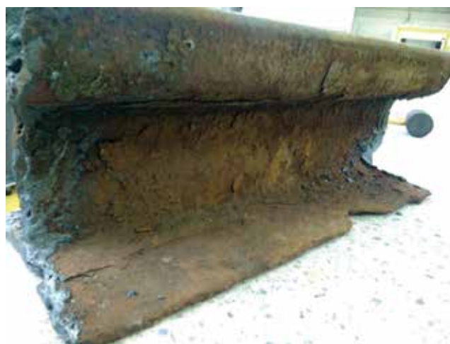
Slika 11. Korozija cijelom duljinom nožice i vrata tračnice, uzorak tračnice iz kolosijeka ugrađenog u cestovnu prometnicu
