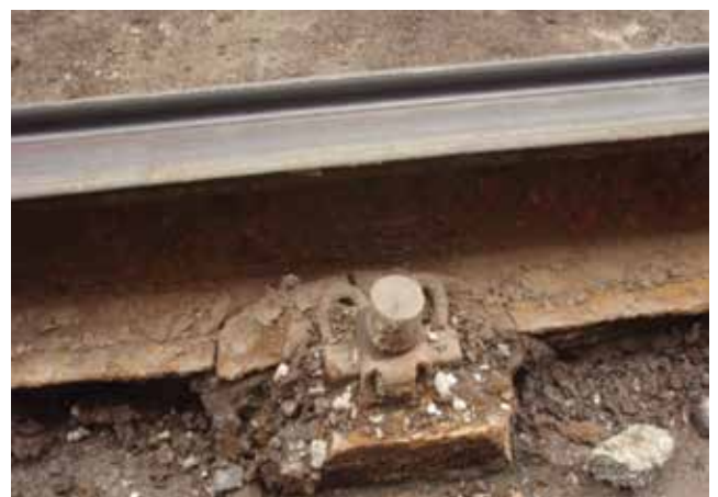
Slika 12. Razaranje nožice tračnice na mjestu pričvršćenja na kolosijeku ugrađenom u cestovnu prometnicu
