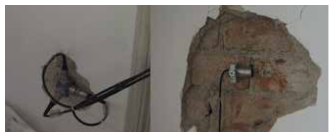
Slika 24. Ugrađeni troosni akcelerometar za mjerenje ubrzanja te ekstenzometar za mjerenje pukotina
