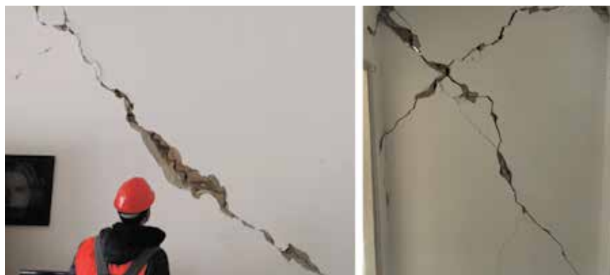
Slika 1. Primjeri oštećenja ziđa u potresu 22. ožujka 2020. u Zagrebu
