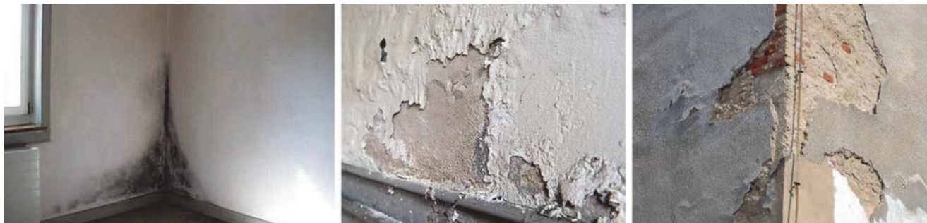
Slika 8. Štete na ovojnici kao posljedica loše kontrole prijenosa topline i vlage
