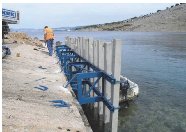
Slika 9. Ispitno polje s izloženim stupovima ispod Krčkog mosta, na kojem su izložene različite vrste nehrđajućih čelika u stvarnom morskom okolišu tijekom zadnjih 10 godina [48]
