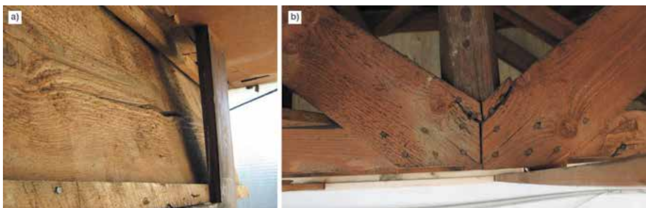
Slika 12. a) Torzijska rotacija greda međukatne konstrukcije; b) Nepravilna ugradnja čavala
