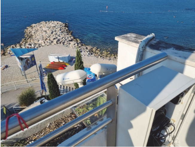
Slika 3. Položaj sustava video nadzora na rubu sportsko-rekreacijskog kompleksa bazeni Kantrida, dvije kamere koje zasebno nadziru istočni i zapadni dio plaže
