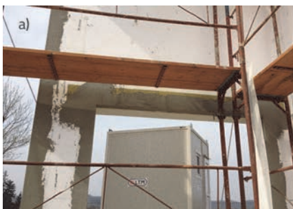
Slika 5. Protupožarna barijera: a) postavljena na uzorku EM_2; b) shema - presjek [14]; c) shema - pogled [14]
