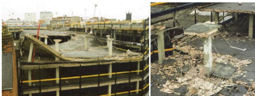
Slika 2. Slom gornje etaže javnog parkirališta u Wolverhamptonu (Engleska) [1]
