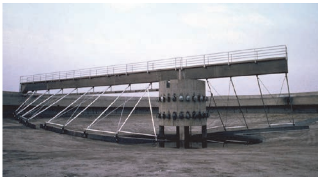
Slika 9. Bazen postrojenja za pročišćavanje otpadnih voda Po-Sangone , Torino, Italija
