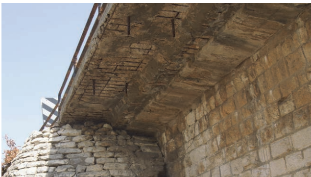
Slika 5. Loše stanje konzola mosta
