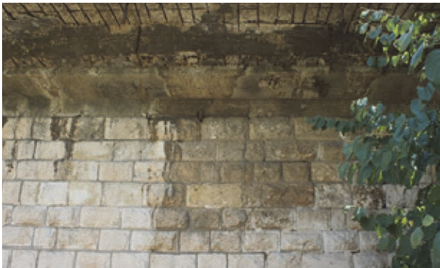
Slika 4. Izbočenje i promjena boje čeonog zida
