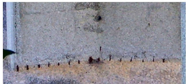
Slika 11. Odlamanje zaštitnog sloja betona na najkritičnijem detalju mosta preko rijeke Slunjičice – veza stupa P7 i luka
