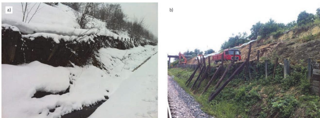
Slika 2. Deformacija primijenjenih mjera sanacije pokosa: a) deformiran montažni betonski zid; b) improvizirane mjere zaštite pokosa
