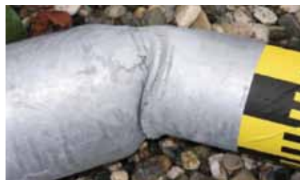
Slika 7. Detalj stupa nakon pada na tlo [6]
