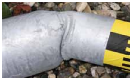
Slika 7. Detalj stupa nakon pada na tlo [6]
