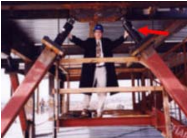
Slika 4. Histerezni prigušivač ugrađen u konstrukciju
