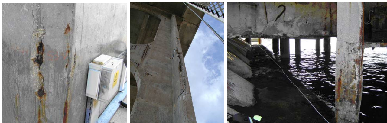
Slika 1. Korozijska oštećenja: a) Maslenički most, b) Krčki most, c) Torpedo, Rijeka
