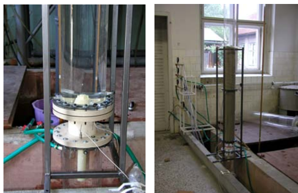
Slika 3. a) ugrađena filtarska sapnica, spojevi piezometara i elektroničkih tlakomjera na fiksno postolje, b) ugrađeni filtarski materijal iznad podnice
