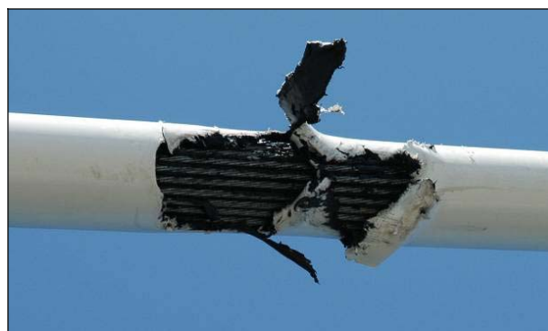
Slika 8. Oštećenje zaštitne cijevi
