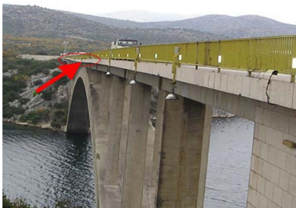
Slika 1. Pogled na Šibenski most na kojem je niveleta prognuta
