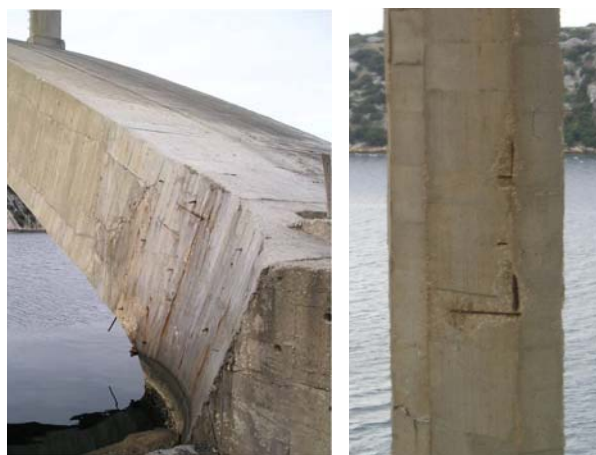
Slika 2. Oštećenja luka u peti i oštećenja stupa
