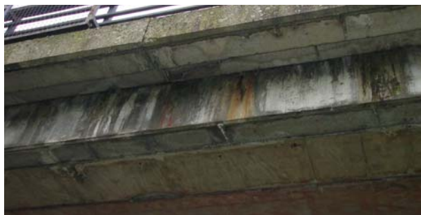
Slika 12. Oštećenja nosača zbog prodora vode ispod elemenata hodnika nadvožnjaka tipa SO
