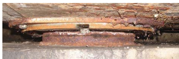
Slika 35. Primjer oštećenog lončastog ležaja
