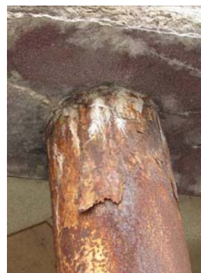
Slika 27. Oštećenje stupa nadvožnjaka tipa IN
