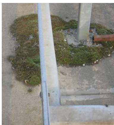
Slika 32. Oštećeno mjesto sidrenja elastičnog odbojnika
