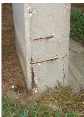
Slika 25. Odlamanje zaštitnog sloja na stupcima nadvožnjaka tipa DK
