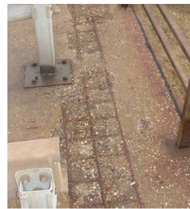
Slika 33. Otkrivena armatura hodnika
