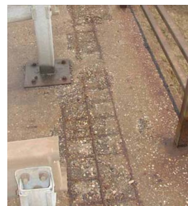
Slika 33. Otkrivena armatura hodnika
