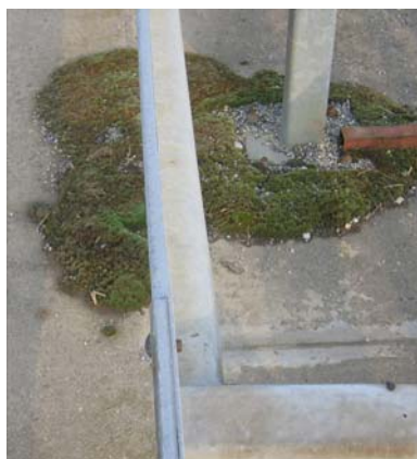
Slika 32. Oštećeno mjesto sidrenja elastičnog odbojnika
