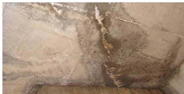
Slika 17. Kose pukotine na nosačima uz oslonce nadvožnjaka tipa PK
