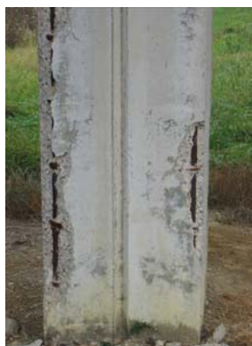
Slika 22. Odlamanje zaštitnog sloja betona na stupcima nadvožnjaka tipa SO
