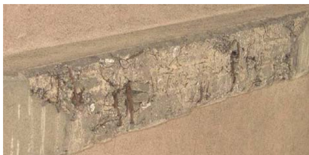
Slika 19. Oštećenja nosača od udara vozila nadvožnjaka tipa IN
