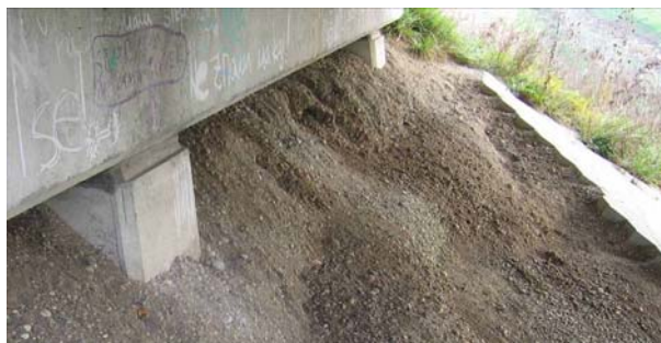
Slika 21. Karakteristično podlokavanje nasipa nadvožnjaka tipova DK, PK i PI
