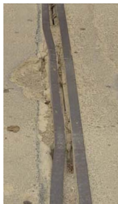
Slika 36. Primjer oštećenja prijelazne naprave
