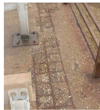
Slika 33. Otkrivena armatura hodnika
