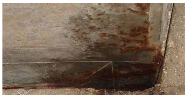
Slika 16. Vlažne mrlje, tragovi korozije i ljuštenje betona nosača nadvožnjaka tipa PK
