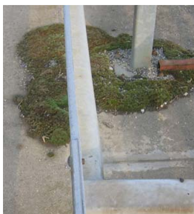
Slika 32. Oštećeno mjesto sidrenja elastičnog odbojnika
