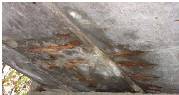
Slika 11. Prodor vode između nosača blizu oslonca nadvožnjaka tipa SO
