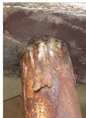
Slika 27. Oštećenje stupa nadvožnjaka tipa IN
