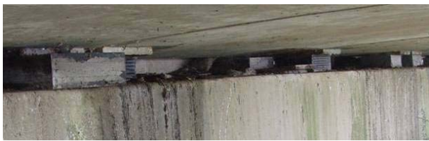
Slika 34. Oštećeni, izmaknuti i ekscentrično opterećeni elastomerni ležajevi
