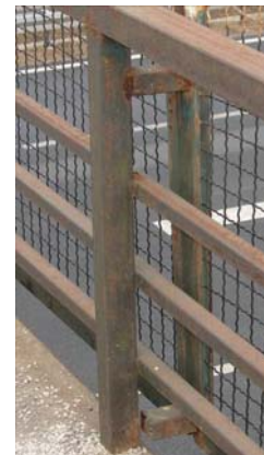
Slika 38. Gubitak presjeka zaštitne ograde na mjestu spoja s ogradom hodnika
