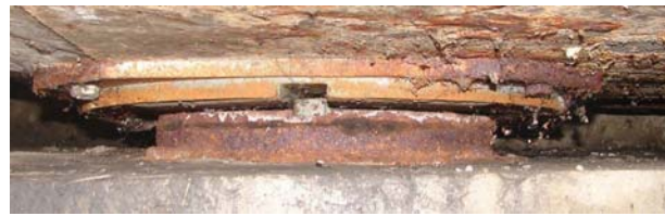
Slika 35. Primjer oštećenog lončastog ležaja
