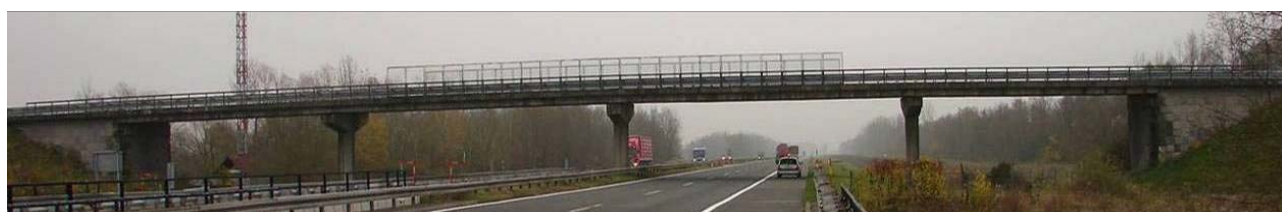
Slika 1. Pogled na jedan od pregledanih nadvožnjaka tipa SO
