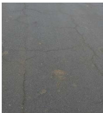
Slika 29. Asfalt prošaran pukotinama
