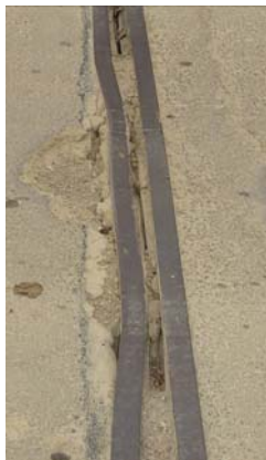
Slika 36. Primjer oštećenja prijelazne naprave
